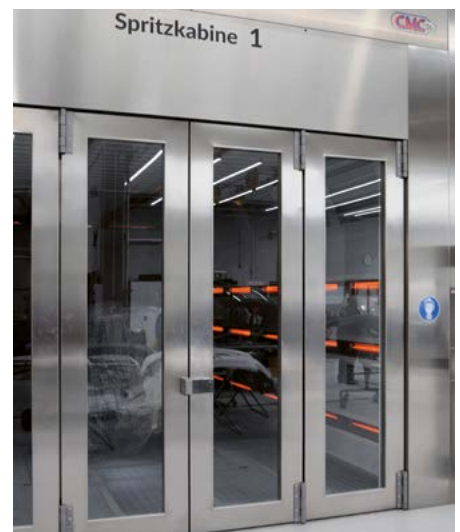
Die Anschaffungskosten sind zwar viel höher, doch die effizienten Infrarotstrahler in der Spritzkabine senken die Energiekosten massiv.
